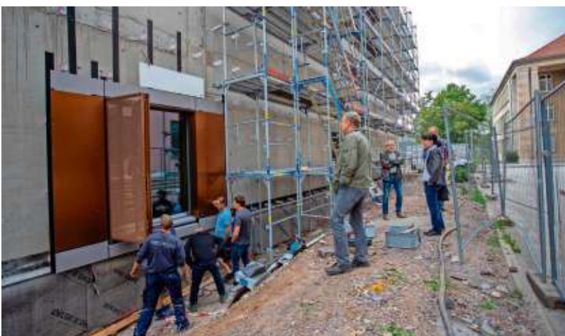
Techniker hatten probeweise einen Teil der geplanten Fassade montiert, um die Funktionsweise der Jalousien und die Farbgestaltung zu demonstrieren.
